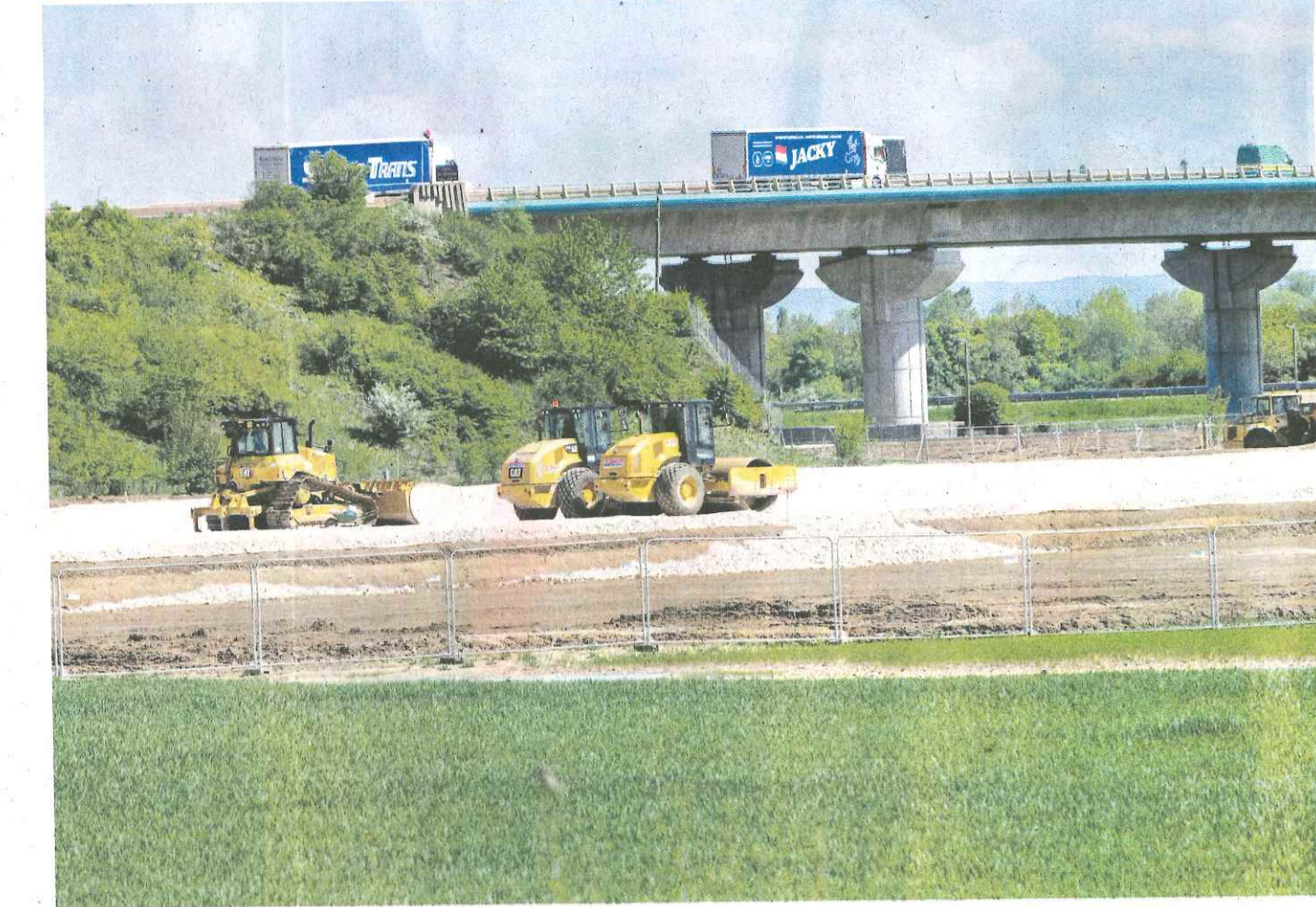
Chantier d'une zone d'activité commerciale sur un ancien champ agricole, dans le Jura, en juin 2022. PIERRE GLEIZES/RÉA
